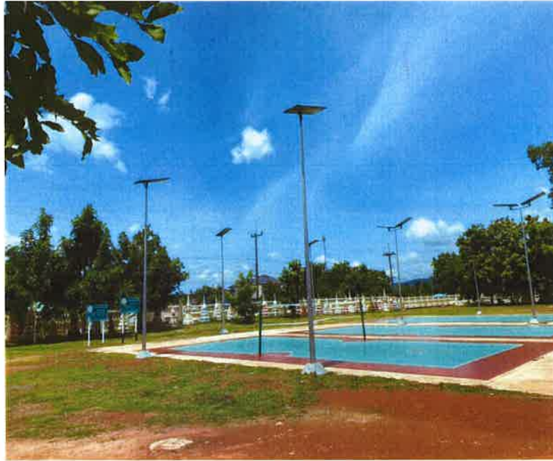
ลานกีฬาออกกำลังกายของชุมชนใช้ไฟฟ้าจากพลังงานแสงอาทิตย์ (โซลาร์เซลล์)
